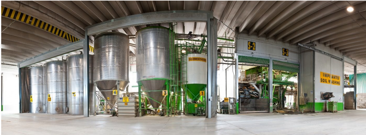
VEDUTA INTERNA IMPIANTO TECNOLOGICO
