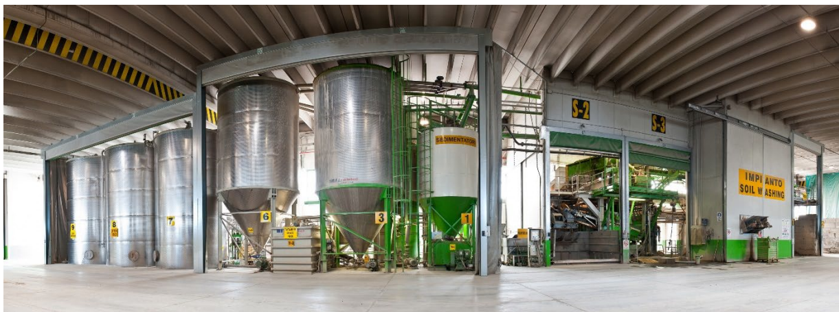
VEDUTA INTERNA IMPIANTO TECNOLOGICO
