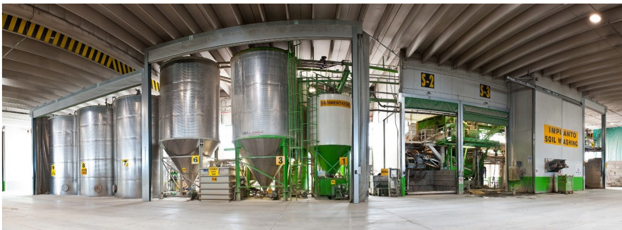
VEDUTA INTERNA IMPIANTO TECNOLOGICO
