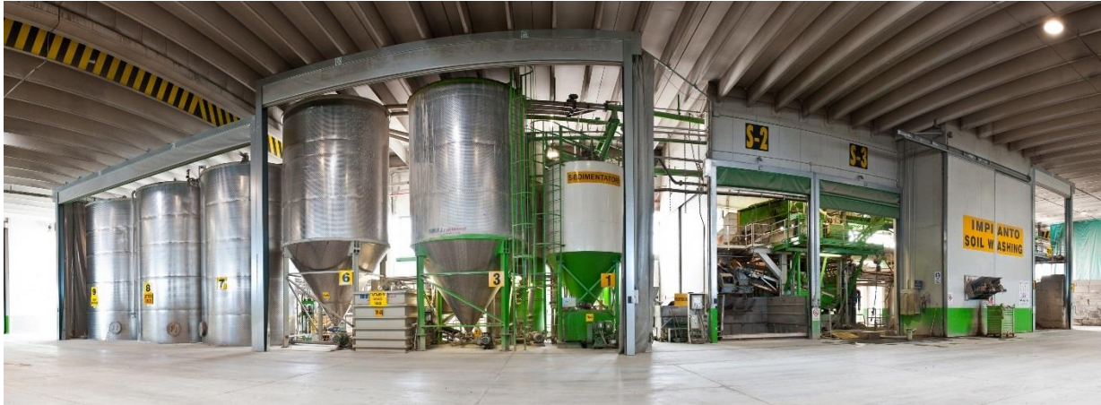
VEDUTA INTERNA IMPIANTO TECNOLOGICO
