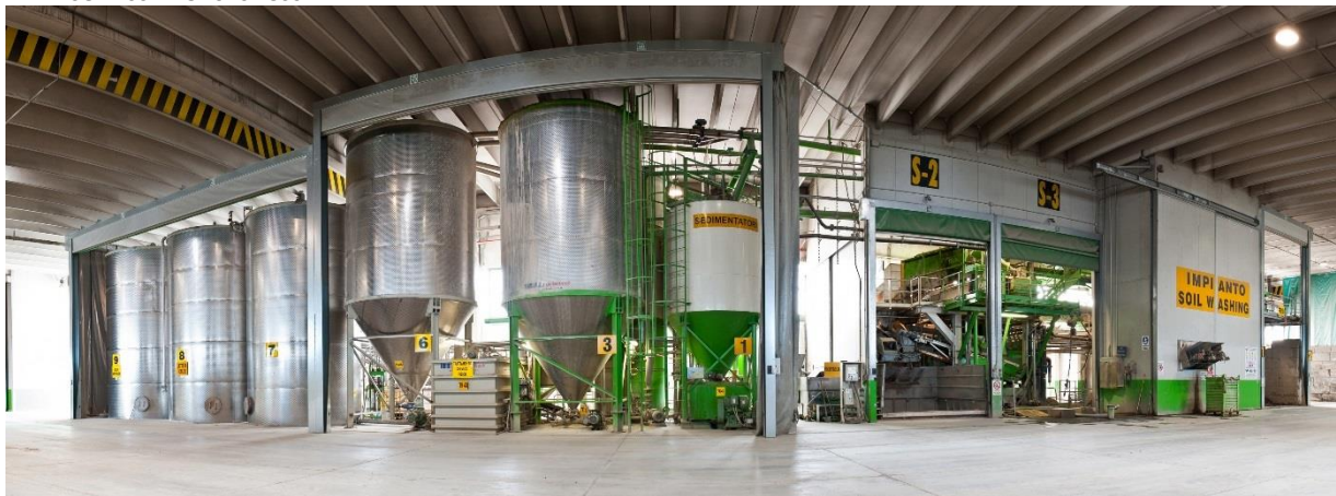
VEDUTA INTERNA IMPIANTO TECNOLOGICO
